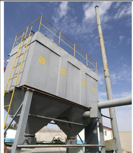
1#布袋除尘器及排气筒
