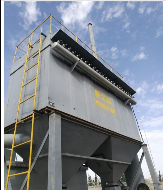
1#布袋除尘器及排气筒
